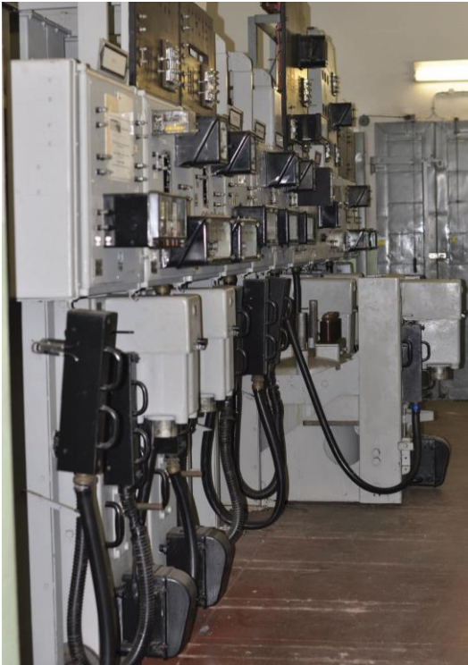
Ausgrid movable heritage switchgear
